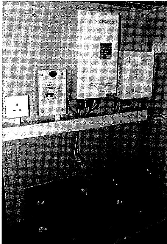
光伏板逆流及蓄電系統
